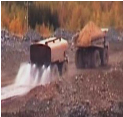
Gambar 35. Jarak Water tank truck terlalu dekat
