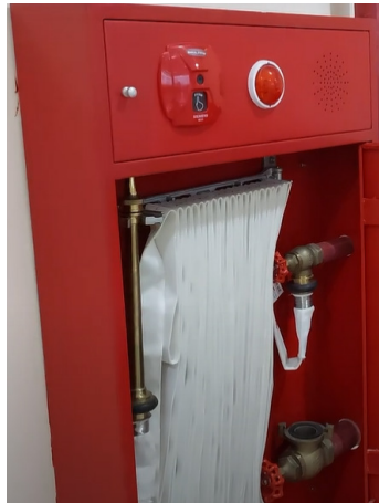
Gambar 67. Hidran gedung (III)
